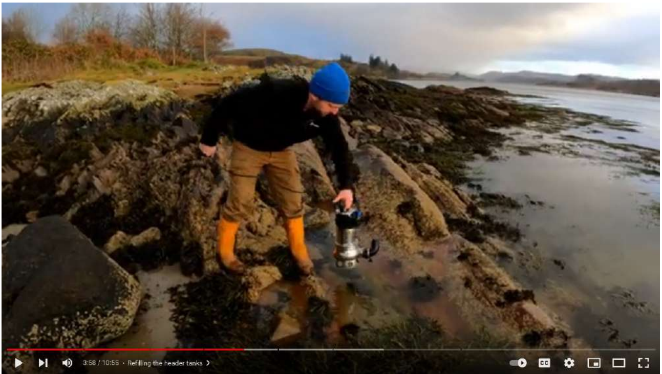
La pompe (en inox) pour le rechargement des bacs de tête.
