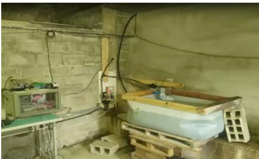
Figure 12 : Bac du local n°2 (Beurivage) : IBC de 1 m 3 coupé en 2. Volume utile 300 L env.
